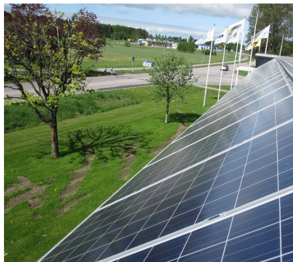
Götene Elförenings solcellsanläggning Järnvägsgatan 29, Götene.
